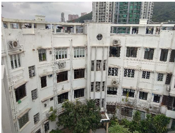
照片 01 樓宇背面立面
